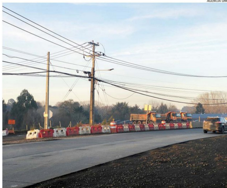
EN LA FOTO SE EVIDENCIA QUE EXISTE SEÑALIZACIÓN. PERO CLARAMENTE RESULTAN INSUFICIENTES.
