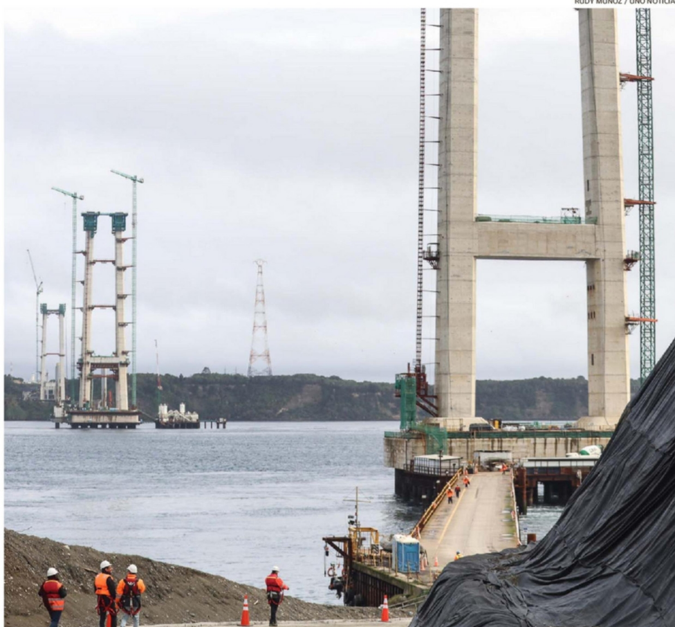
LA OBRA CONTEMPLA LA CONSTRUCCIÓN DE UNA PASARELA A 200 METROS SOBRE EL MAR PARA INSTALAR EL CABLEADO.
