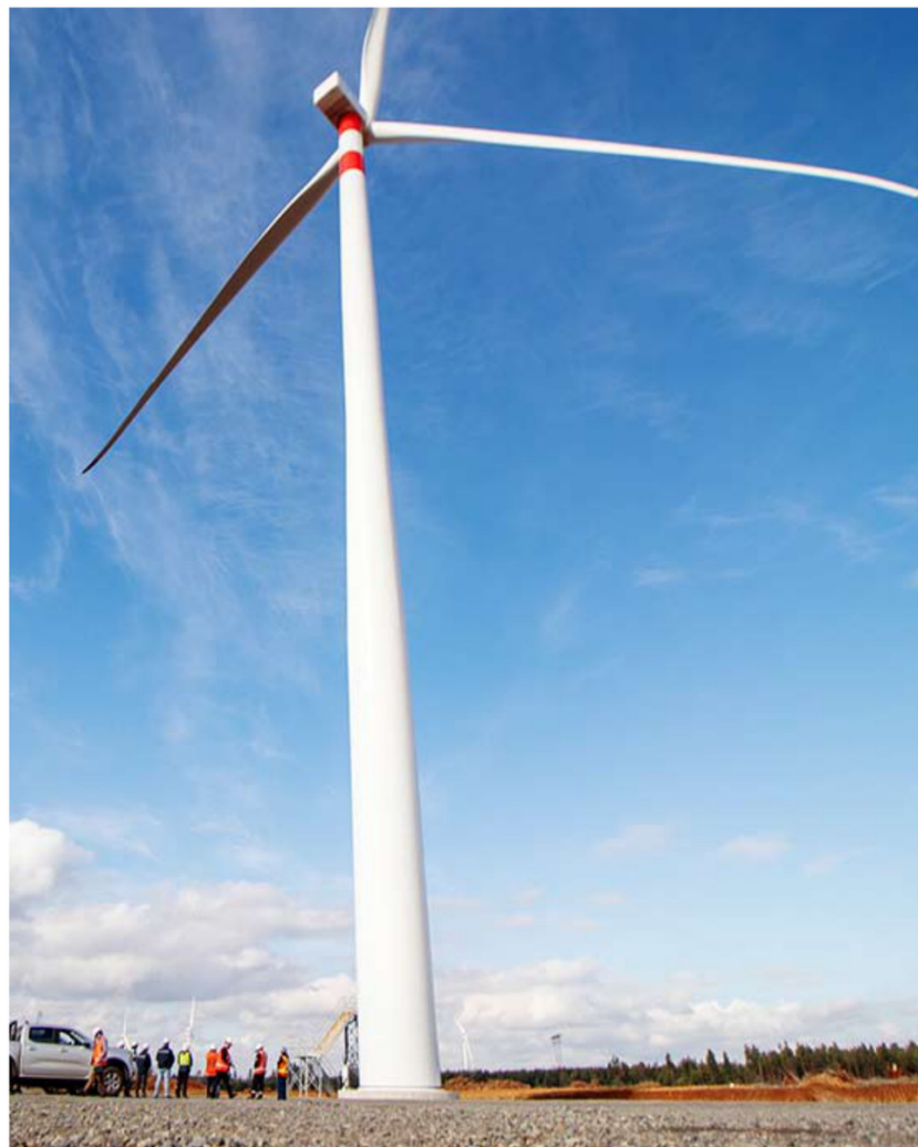
Tres aerogeneradores ya se encuentran conectados a la red.
