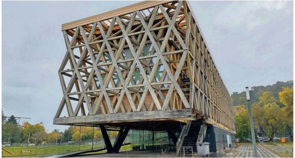
EL PABELLÓN, INSTALADO A FINES DE 2016 A LOS PIES DEL CERRO ÑIELOL, EN TEMUCO, HA SUFRIDO POR LA HUMEDAD, LA LLUVIA Y EL CALOR.
