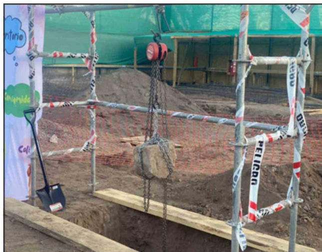
Tragedia enluta obras del nuevo Cesfam de Curimón (Imagen de archivo).
