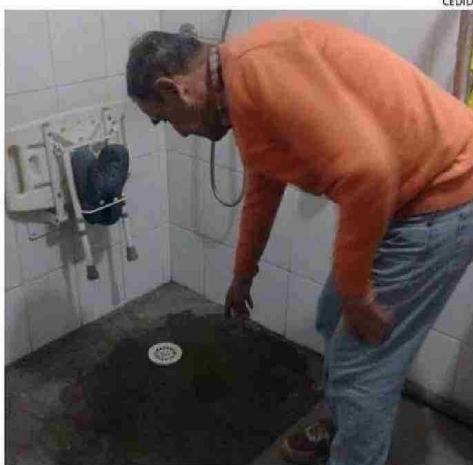
ROTURA DE CAÑERÍAS CAUSÓ INGRESO DE AGUAS SERVIDAS.
