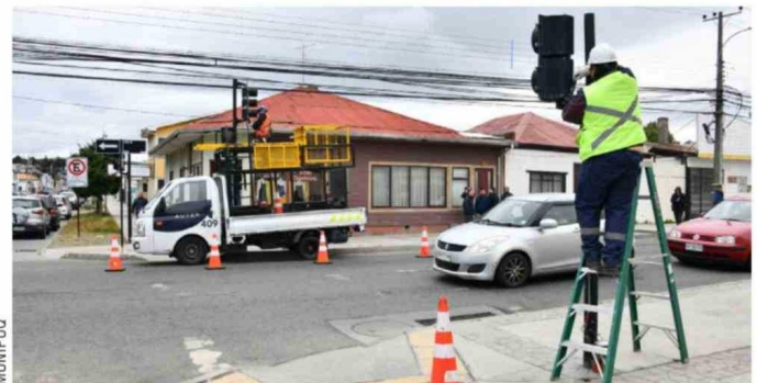
Municipio asegura mantención de semáforos en Punta Arenas.
