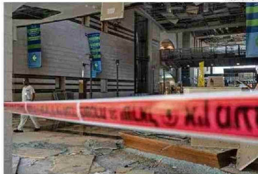
A PESAR DE LOS DAÑOS, EL HOSPITAL SIGUE ATENDIENDO.
