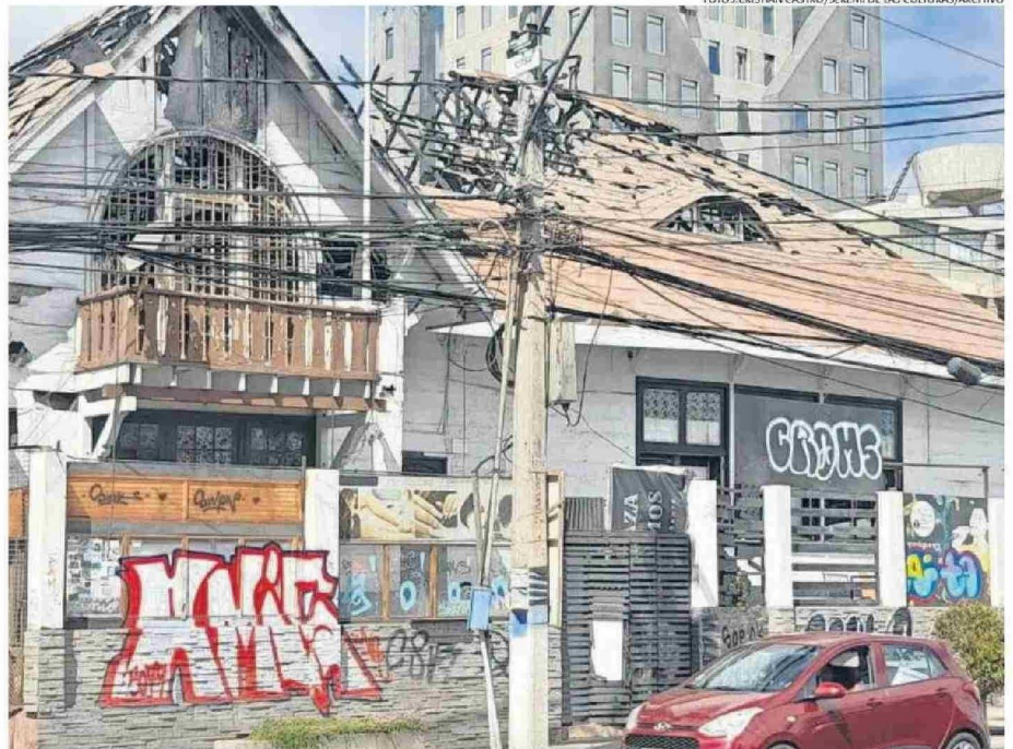
HOY EL INMUEBLE LUCE DETERIORADO NO SOLO POR EL INCENDIO, SINO POR LOS RAYADOS Y LA EVIDENTE FALTA DE INTERVENCIÓN.
