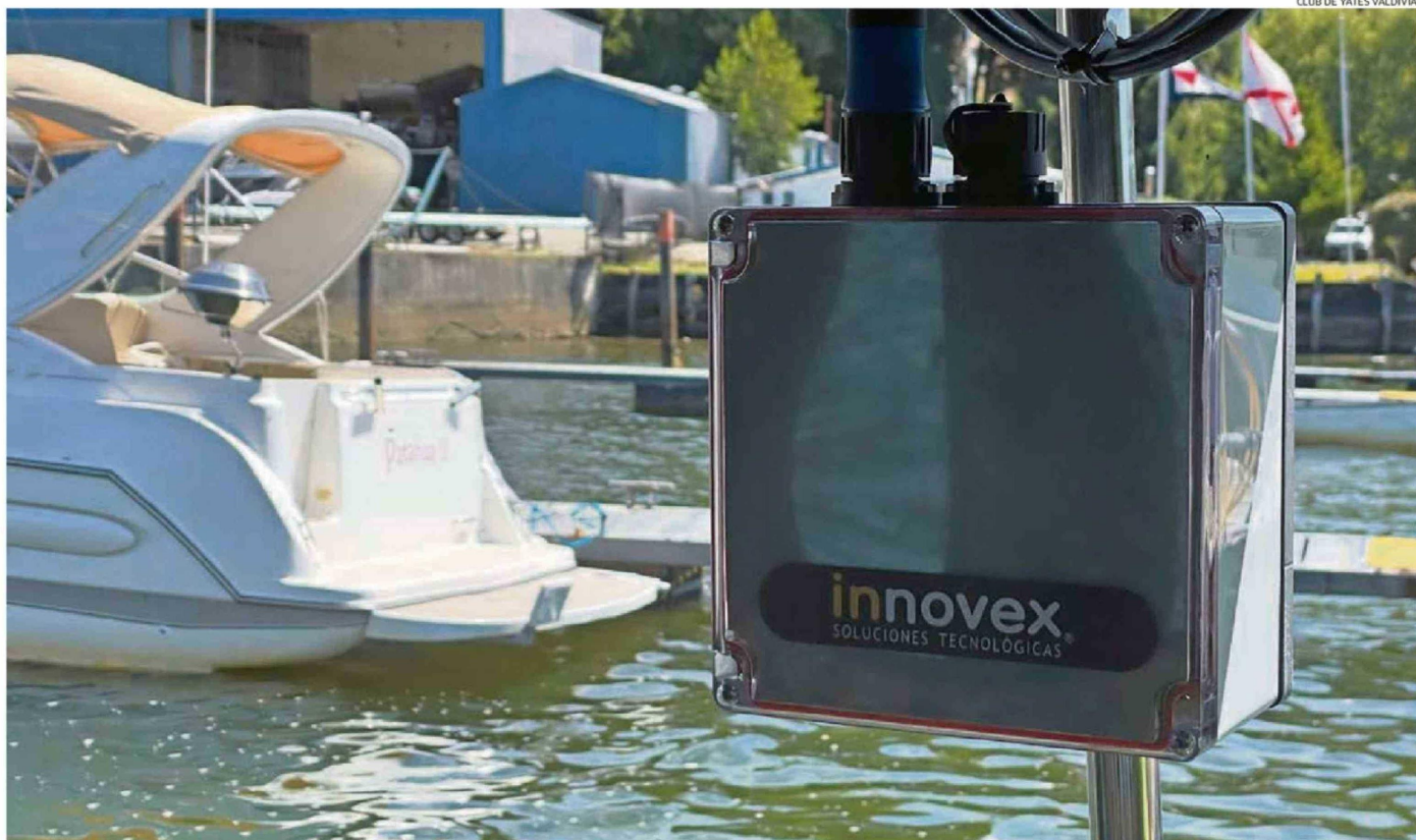
DENTRO DEL EQUIPAMIENTO DE MONITOREO FLUVIAL INSTALADO EN LA RIBERA DEL RÍO VALDIVIA, SE ENCUENTRA UN RADAR DE OLAS QUE FUE DISEÑADO POR LA EMPRESA LOCAL INNOVEX.
