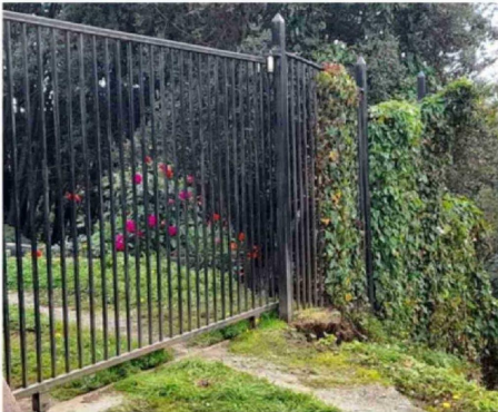
PARTE DEL CERCO DE UNA VIVIENDA QUEDÓ EN EL AIRE.
