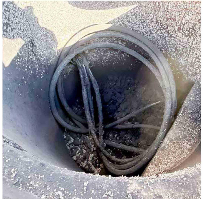
Una persona ingresó a una subestación energizada y, al intentar manipular cables eléctricos, recibió una potente descarga que le provocó quemaduras en el 90% de su cuerpo.
