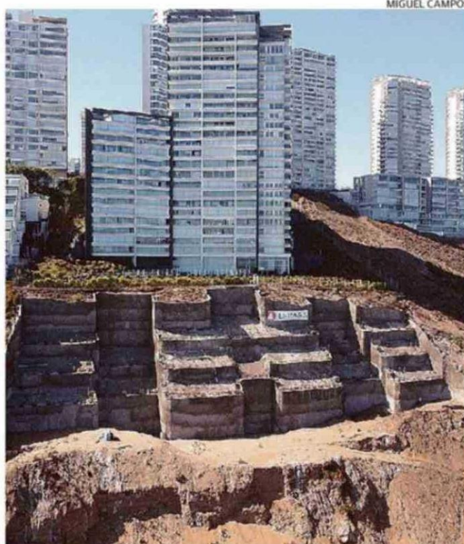
CONSTRUCCIÓN SE MANTIENE PARALIZADA DESDE EL AÑO 2020.
