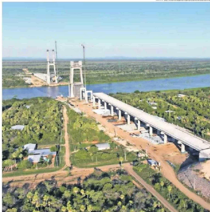
EL PUENTE DE LA BIOCEÁNICA, QUE CONECTARÁ LAS CIUDADES DE CARMELO PERALTA Y PUERTO MURTINHO.
