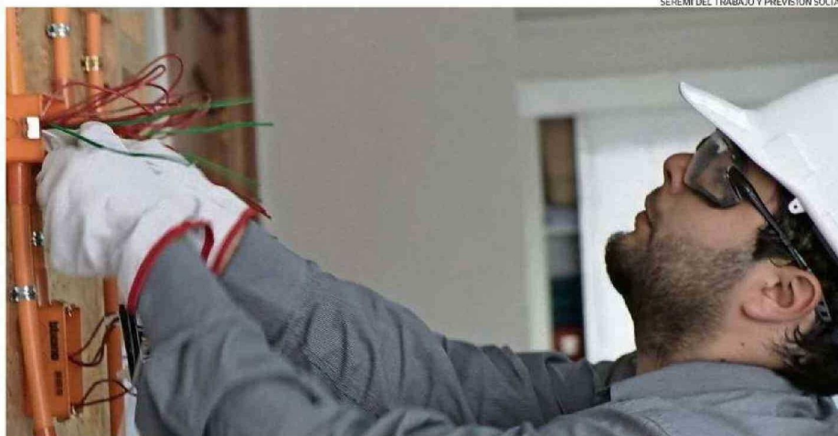
EL OFICIO DE INSTALADOR ELÉCTRICO CLASE D FUE EL QUE CONCENTRÓ EL MAYOR PORCENTAJE DE TRABAJADORES CERTIFICADOS EN EL 2024.
