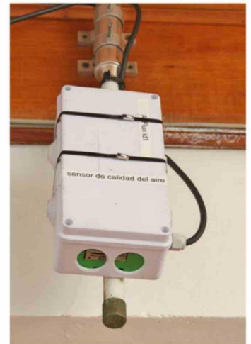
Uno de los sensores de monitoreo de calidad del aire instalados en las dependencias del Liceo Inglés Saint John.
