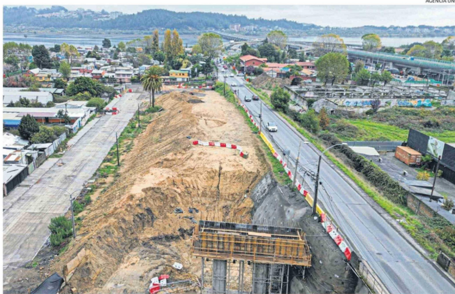
OBRAS PARALIZADAS EN EL PUENTE ESMERALDA, QUE UNE LA COSTANERA NORTE DEL BIOBÍO CON EL CENTRO DE CONCEPCIÓN.
