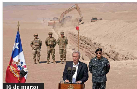
16 de marzo En Arica, el mandatario supervisó directamente el inicio de la construcción de zanjas en la frontera que buscan dificultar el ingreso irregular al país.
