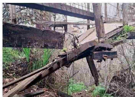
LA ESTRUCTURA ES UN PELIGRO PARA LOS TRANSEÚNTES.
