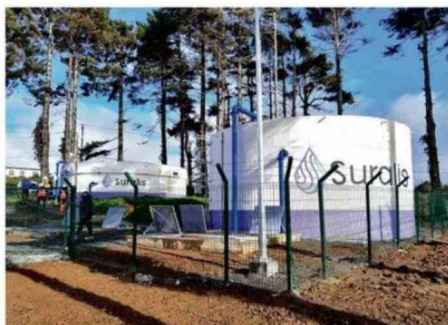
Estanques de Almacenamiento de Maullín
