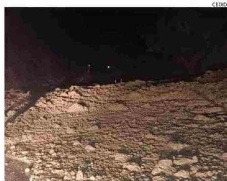
EL DERRUMBE CERCA DE VILLA SANTA LUCÍA CUBRIÓ TODA LA VÍA.
