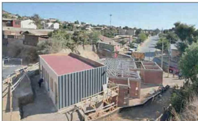
La nueva infraestructura reemplazará la antigua sede social que data de los años 60, dando paso a un recinto moderno de 255 metros cuadrados en dos niveles.
