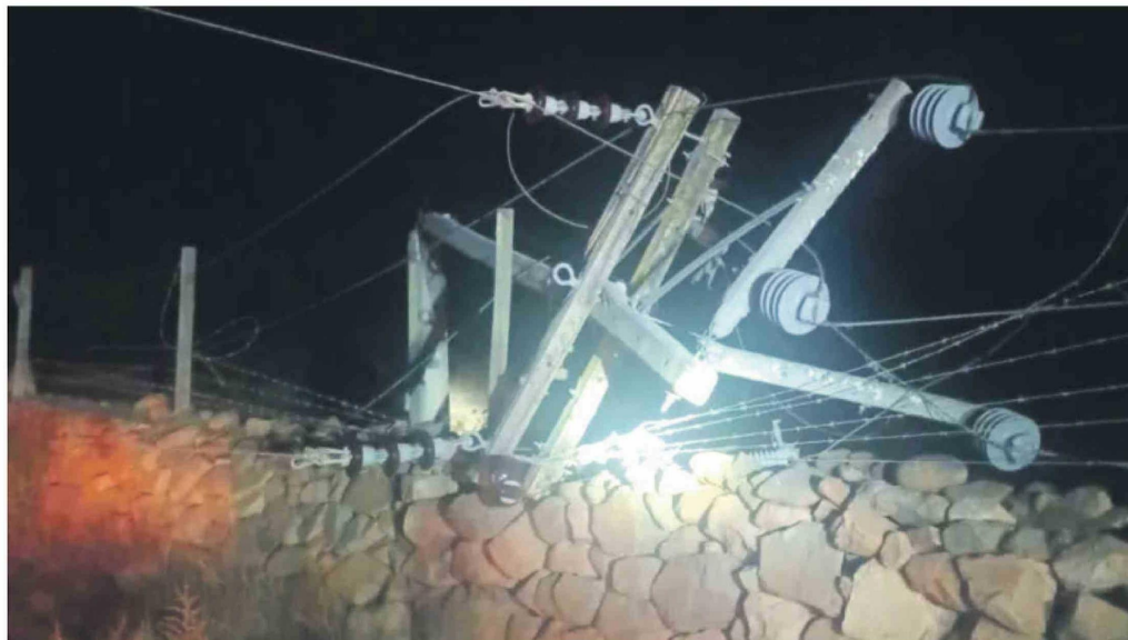
Seis postes derribados y 1.500 metros de cable sustraído dejó un nuevo robo en Llanos de Tabalí, afectando a sectores rurales de Ovalle.
