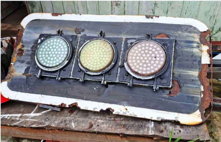
ESTA SEÑALÉTICA ELÉCTRICA QUE SE DESPRENDIÓ POR EL VIENTO MUESTRA EVIDENTE OXIDACIÓN.
