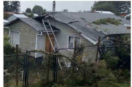
HUBO VOLADURAS DE TECHOS EN DISTINTAS COMUNAS.
