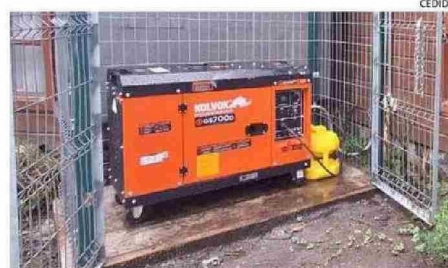
EQUIPO EN LA BASE UBICADA EN LA VILLA GUARELLO DE CASTRO.
