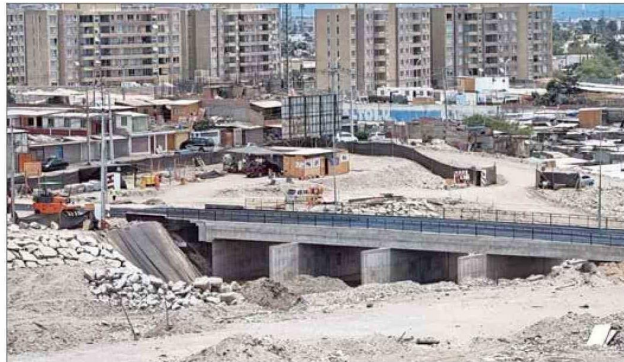
Radio urbano Según el Ministerio Público habría irregularidades en la pavimentación de este puente que cruza el cauce del río San José.
