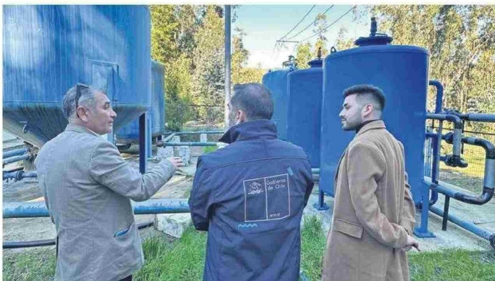
Uno de los títulos corresponde al sitio donde opera la planta de tratamiento de agua.
