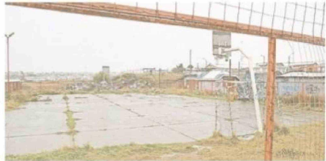
Esta multicancha presenta un fuerte grado de destrucción.
