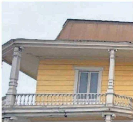
LOS BALCONES Y LA ESTRUCTURA PRESENTAN DETERIORO.
