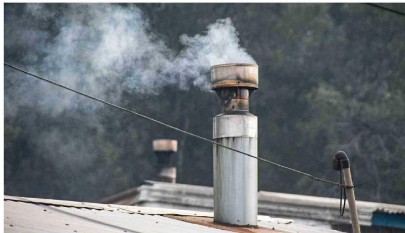
LA MANTENCIÓN DE DUCTO de estufa a leña, una de las principales medidas para prevenir incendios durante el invierno.
