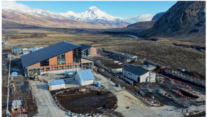
LA INICIATIVA CONTEMPLA la modernización del actual paso fronterizo, reemplazando instalaciones provisionarias por un recinto de alto estándar que mejorará la atención de usuarios y reforzará el control fronterizo.
