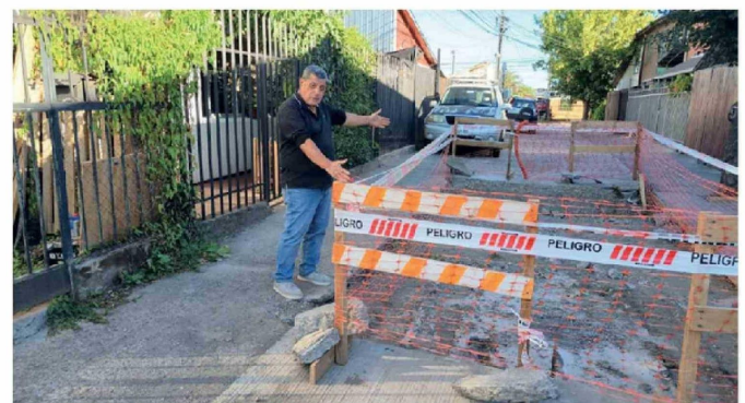
LOS RESIDENTES DE PASAJE IQUIQUE exigen que se pavimente el tramo que falta y se retiren los escombros, ya que es un riesgo de accidente para quienes habitan el sector.
