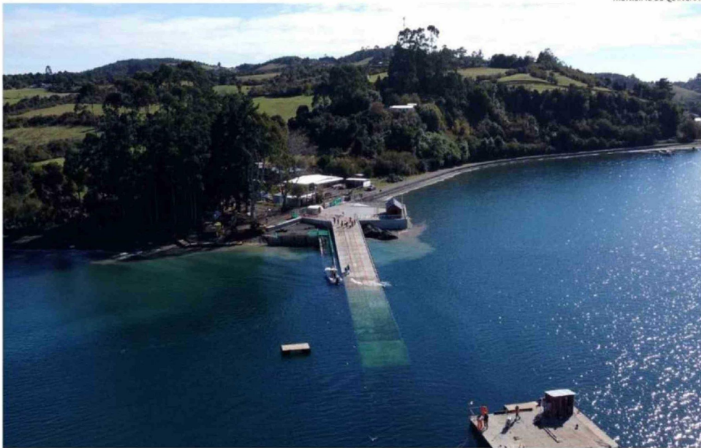
EN LA FASE DE TERMINACIONES SE ENCUENTRAN LOS TRABAJOS EN LA ISLA QUINCHAÍNA.
