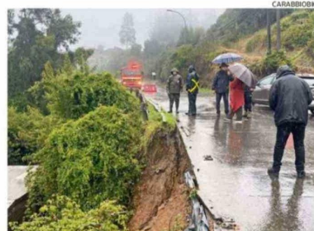
Un deslizamiento de tierra ayer en la Región del Biobío.
