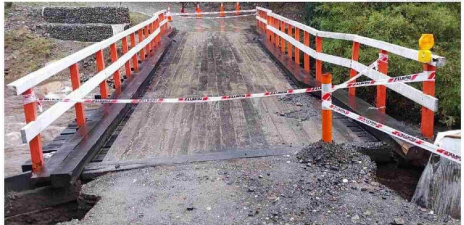
EN SAN JUAN DE LA COSTA ESTÁ CERRADO EL ACCESO AL PUENTE QUILLOIMO, QUE PRESENTA UN SOCAVÓN DEL TERRENO EN UNO DE LOS ACCESOS.
