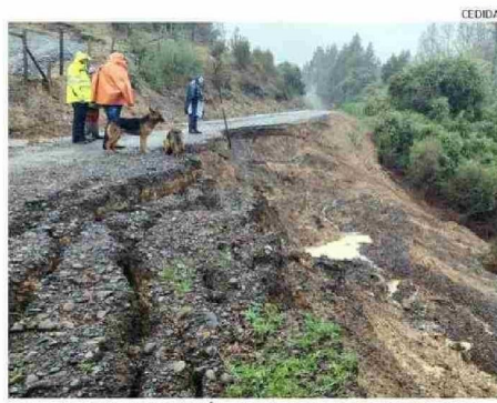
EN EL SECTOR DE CHEUQUEMÓ HUBO UN DESLIZAMIENTO DE TERRENO.
