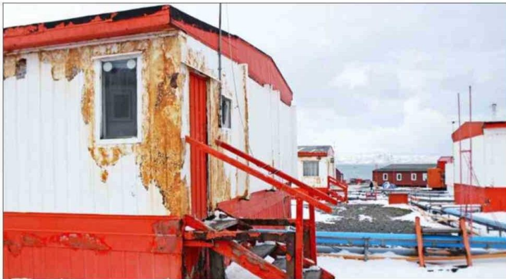
Varías de las viviendas desocupadas en 2018 , afectadas por la corrosión y con instalaciones de servicios básicos deficientes, aún esperan una renovación.
