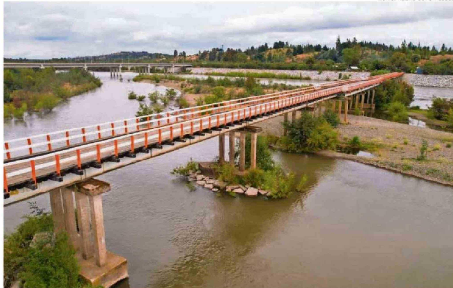
A FINES DE FEBRERO DE ESTE AÑO, VECINOS ALERTARON A BOMBEROS DE UN INCENDIO REGISTRADO EN EL PUENTE.
