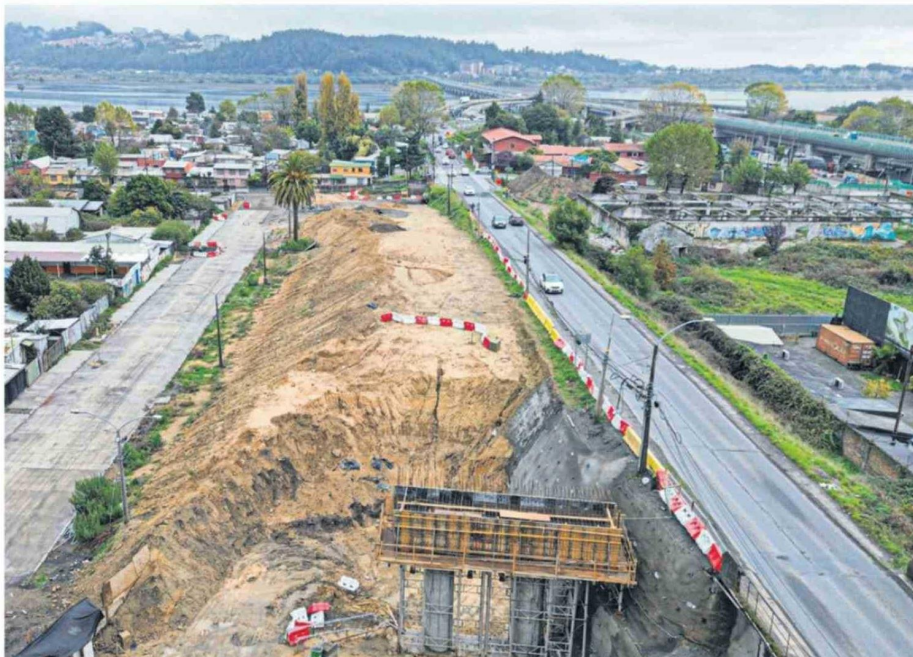
Las obras en el enlace Esmeralda de Concepción apenas alcanzan el 20% de avance tras la salida anticipada de Tapusa.
