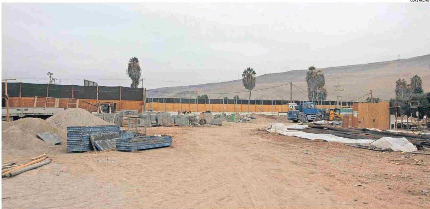
ASÍ LUCIÁN LAS OBRAS EN 2023, FECHA EN QUE LOS TRABAJOS DE ESTA OBRA EMBLEMÁTICA PARA LA REGIÓN QUEDARON PARALIZADAS.
