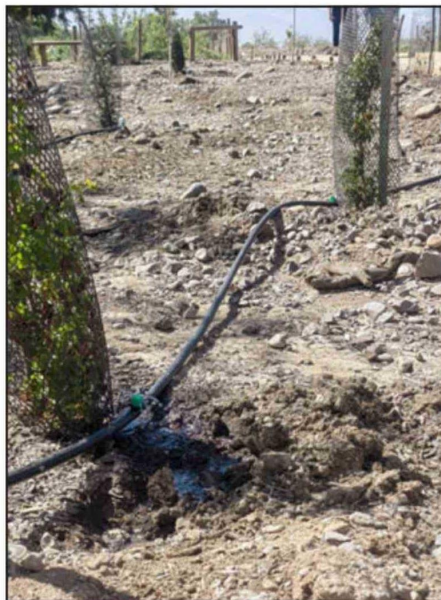
El sistema de riego tecnificado instalado en el lugar permite asegurar el crecimiento y mantención de más de 400 árboles.
