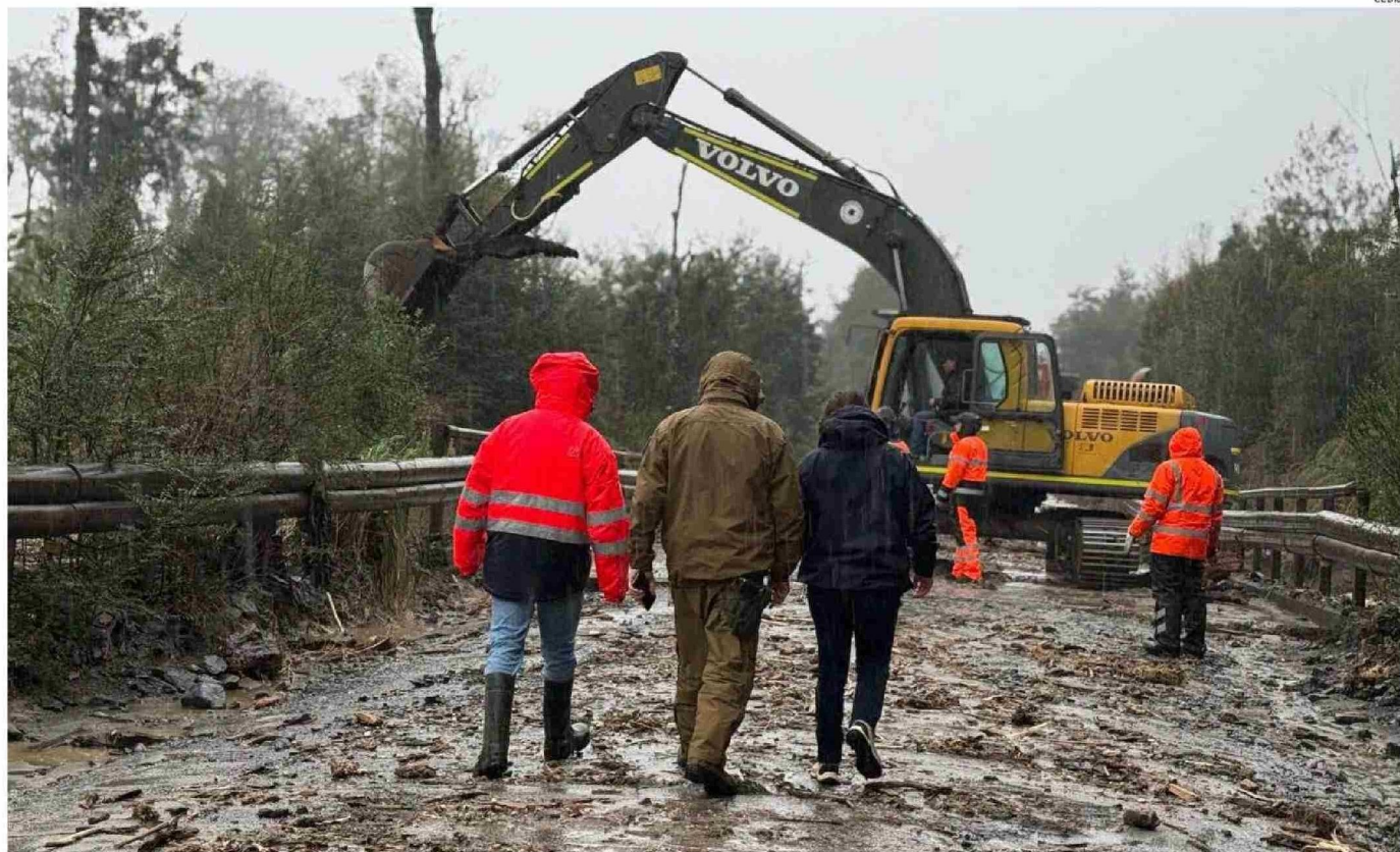
DESDE AYER SE MANTIENE INTERRUMPIDO EL TRÁNSITO VEHICULAR EN EL KILÓMETRO 180 DE LA CARRETERA AUSTRAL (PUENTE DON BACHE).
