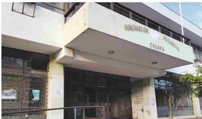
Con los años de abandono la estructura se ha ido deteriorando dejando una mala imagen en pleno centro cívico de la comuna de Illapel.
