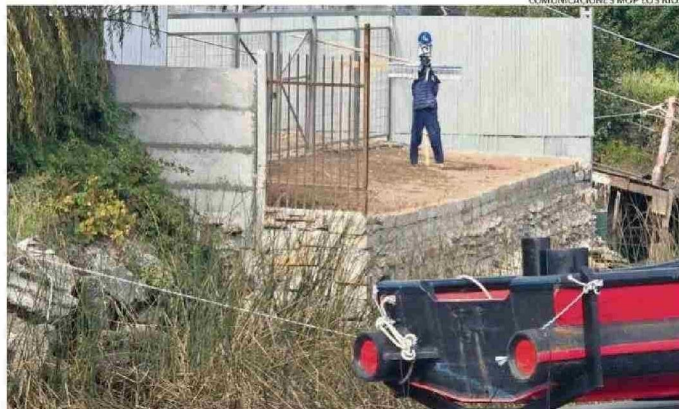
EL PARTICULAR CONSTRUYÓ UN MURO TIPO DEFENSA FLUVIAL, SIN AUTORIZACIÓN DE LA DIRECCIÓN DE AGUAS.
