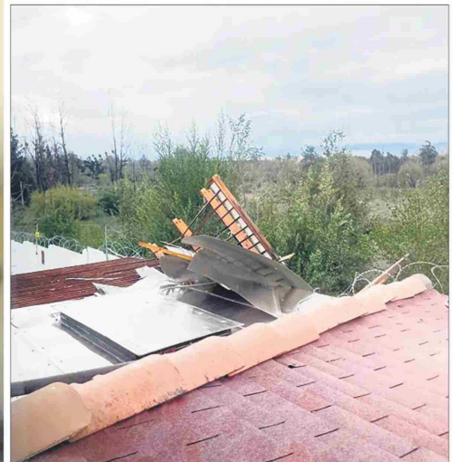
La vista del desastre desde el segundo piso.
