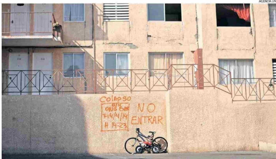
EL 1 DE ABRIL DEL 2014 IQUIQUE SUFRIÓ UN TERREMOTO QUE DAÑÓ A VARIAS VIVIENDAS.
