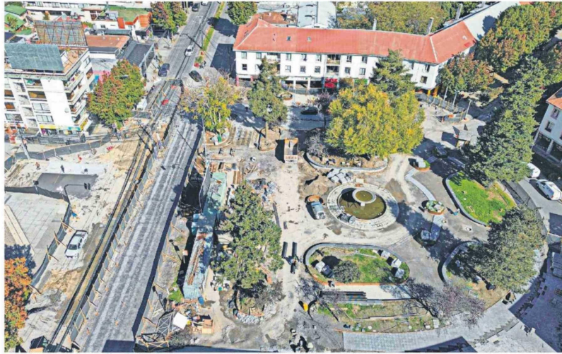
Vista aérea de los trabajos en Plaza Perú. La demora genera varios dolores de cabeza en los vecinos del sector.
