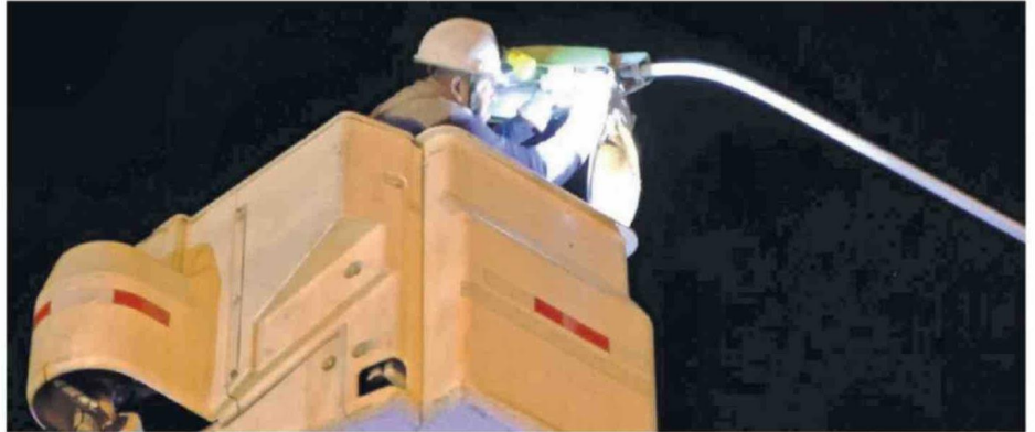
LAS NUEVAS LUMINARIAS EN COPIAPÓ CUMPLIRÁN CON LAS NORMATIVAS DE MITIGACIÓN DE LA CONTAMINACIÓN LUMÍNICA Y ADEMÁS AHORRARÁN ENERGÍA.
