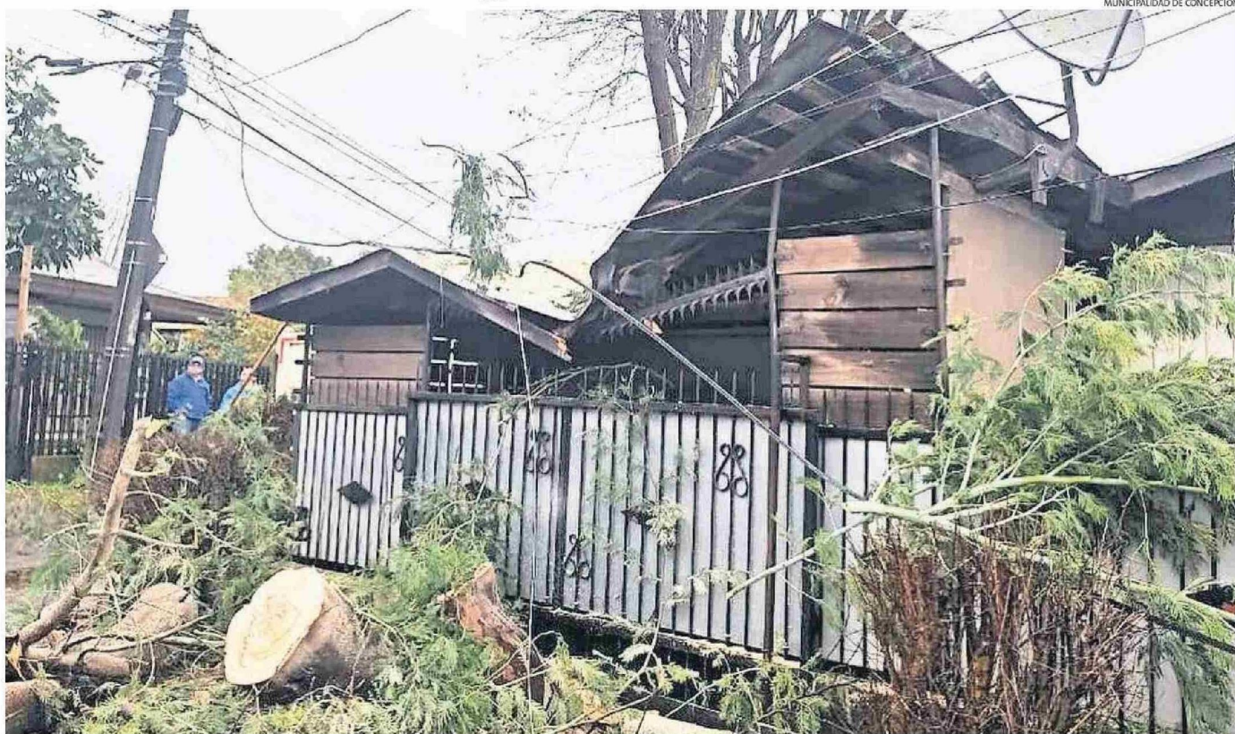
LAS VIVIENDAS DESTRUIDAS POR EL TEMPORAL SE CONCENTRARON EN LA COMUNA DE CONCEPCIÓN, DONDE HUBO 4 CASOS DE ESTE TIPO, SUMADO A CAÍDAS DE ÁRBOLES Y VOLADURAS DE TECHUMBRES.
