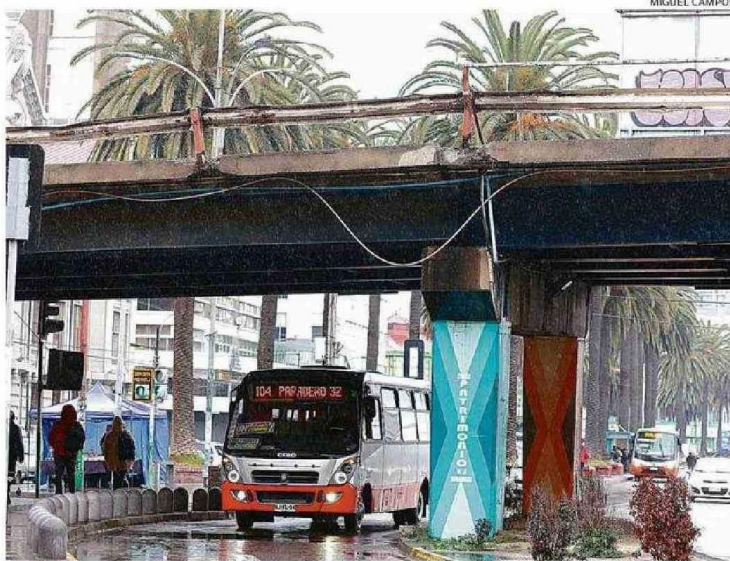
LA VÍA ELEVADA EN EL NUDO BARÓN PRESENTA UN VISIBLE DETERIORO EN SU EXIGIDA INFRAESTRUCTURA.
